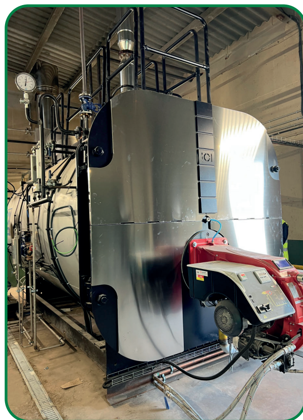
Nou generador de vapor a la fàbrica de Torregrossa
